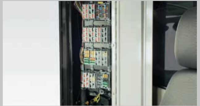
Панель электрических предохранителей.
